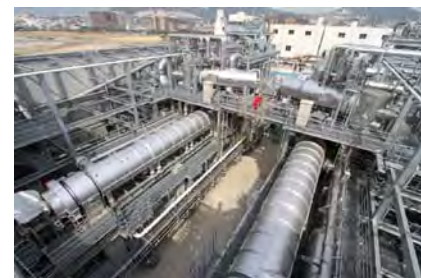
下水汚泥燃料化システム
