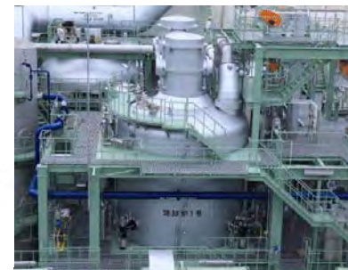
次世代型 汚泥焼却システム
