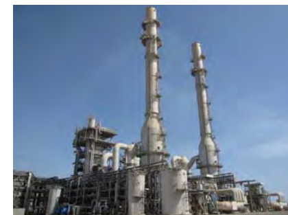
廃液燃焼システム
