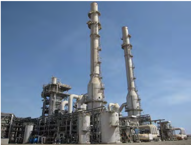
廃液・廃ガス処理設備
