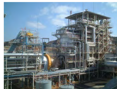
固形廃棄物処理設備
