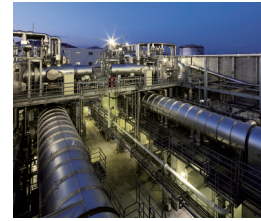
燃料化施設(下水汚泥燃料化システム)
