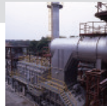
「一般廃棄物焼却設備」
