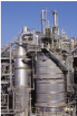
ポリカーボネートの原料であるBPAを製造する「BPA製造プラント」
