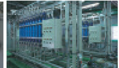
より清澄な水を造る「膜ろ過設備」
