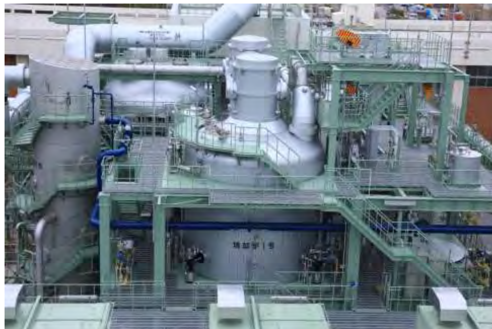
次世代型汚泥焼却設備(過給式流動燃焼システム)
