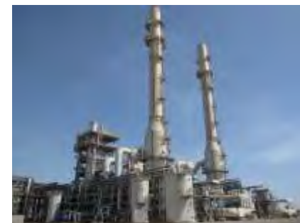
廃液燃焼システム
