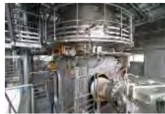
▲ 甲府市甲府浄化センター 焼却施設外観
