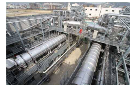
下水汚泥燃料化システム
