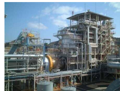
固形廃棄物処理設備
