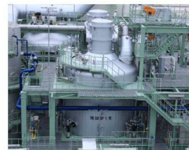
次世代型 汚泥焼却システム
