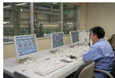
処理場オペレーター室
