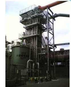
排煙脱硫設備
