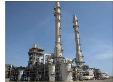
廃液燃焼システム
