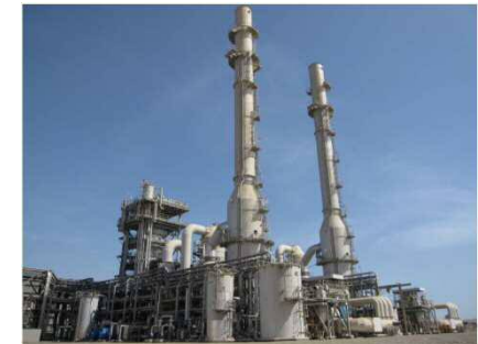
廃液燃焼システム
