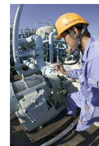
設備メンテナンス
