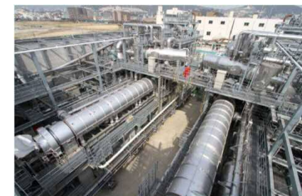
下水汚泥燃料化システム
