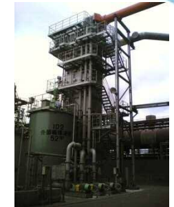
排煙脱硫設備
