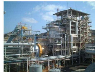
固形廃棄物処理設備
