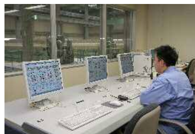
処理場オペレーター室
