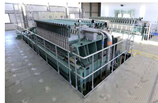
犬山浄水場 脱水設備
