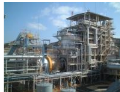
固形廃棄物処理設備
