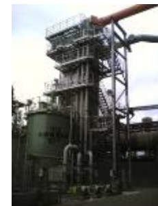
排煙脱硫設備
