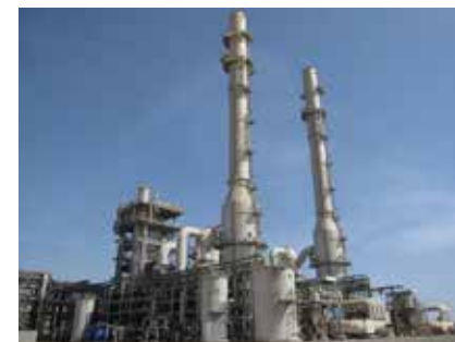
廃液燃焼システム
