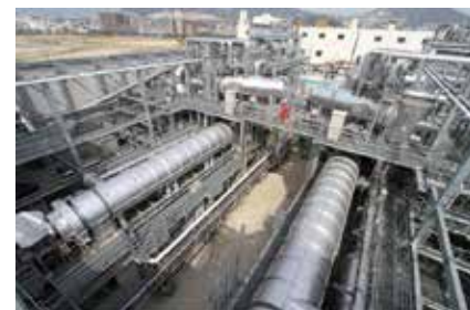
下水汚泥燃料化システム
