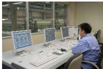
処理場オペレーター室
