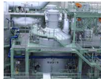
次世代型 汚泥焼却システム
