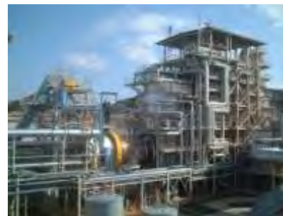
固形廃棄物処理設備
