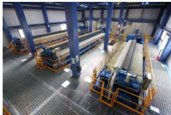
排水処理設備における主要機器：加圧脱水機
