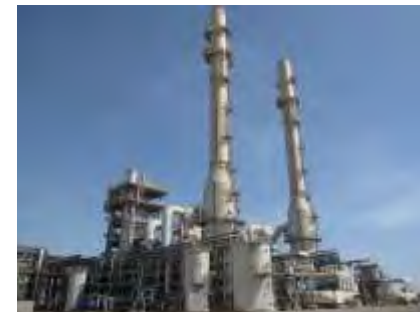
廃液燃焼システム
