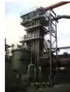
排煙脱硫設備
