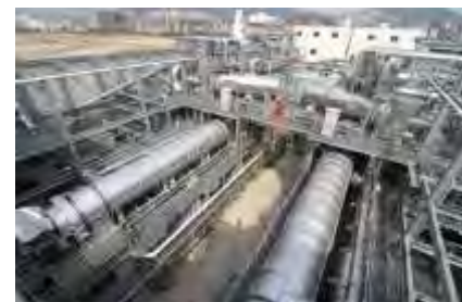
下水汚泥燃料化システム
