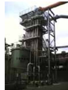
排煙脱硫設備
