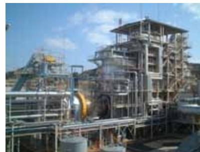
固形廃棄物処理設備
