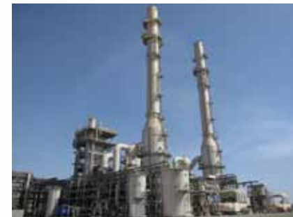
廃液燃焼システム
