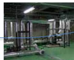
空調・ヒートポンプ
