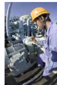
設備メンテナンス
