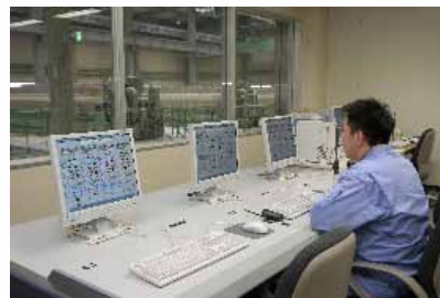
処理場オペレーター室
