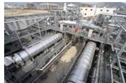
下水汚泥燃料化システム
