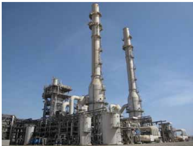
廃液焼却システム 写真
