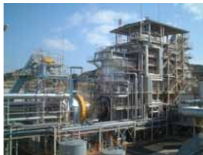
固形廃棄物処理設備
