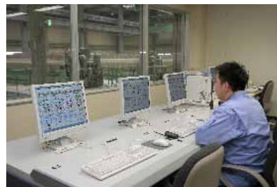
処理場オペレーター室
