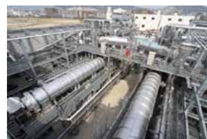
下水汚泥燃料化システム
