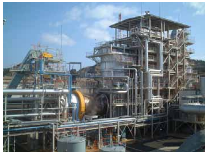
固形廃棄物焼却設備 写真
