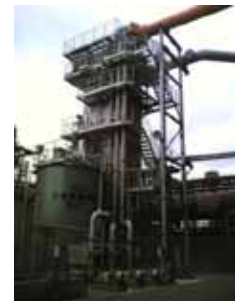
排煙脱硫設備
