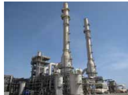
廃液燃焼システム
