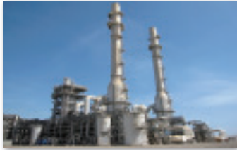
廃液燃焼設備 (サウジアラビア)
