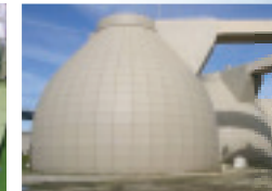
⑤汚泥を発酵する消化槽
