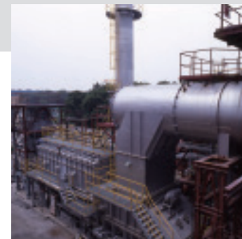
「一般廃棄物焼却設備」
