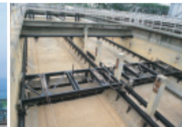
2 沈殿池の泥を掻き寄せる「水没クラリファイヤ」
