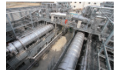
広島市向け汚泥燃料化施設
