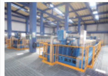
3 濃縮した浄水汚泥を脱水し減容化する「加圧脱水機」
