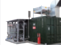
⑥消化ガスを燃料として発電するガスエンジン
