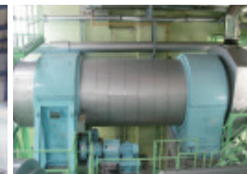
4 脱水した浄水汚泥を乾燥し、園芸用土等へ有効利用する「乾燥設備」
