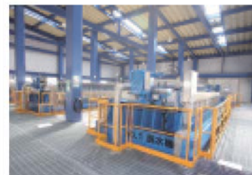
③ 濃縮した浄水汚泥を脱水し減容化する「加圧脱水機」
