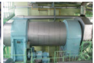
④ 脱水した浄水汚泥を乾燥し、園芸用土等へ有効利用する「乾燥設備」
