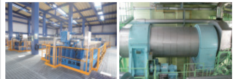
3 濃縮した浄水汚泥を脱水し減容化する「加圧脱水機」
