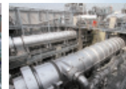
⑩ 汚泥を燃料化して石炭代替燃料とする「下水汚泥燃料化システム」
