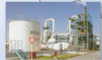
PTアサヒマスケミカル向け塩酸回収設備 (インドネシア)
