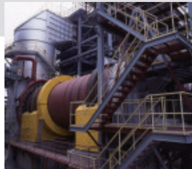
「産業廃棄物焼却設備」
