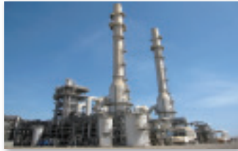
廃液燃焼設備 (サウジアラビア)
