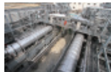
広島市向け汚泥燃料化施設
