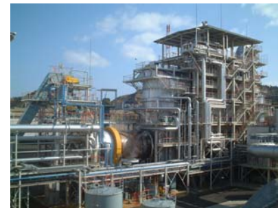
固形廃棄物処理設備
