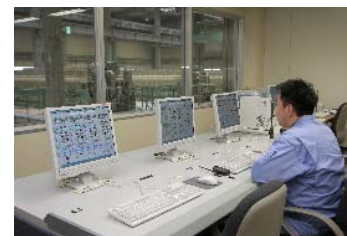
処理場オペレーター室
