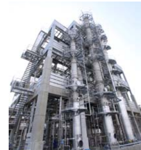
バイオマスエタノール製造設備
