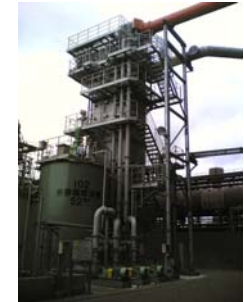
排煙脱硫設備
