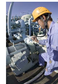
設備メンテナンス
