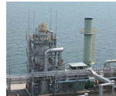
廃液燃焼設備
