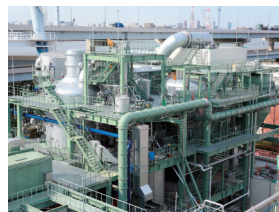
過給式流動燃焼システム
