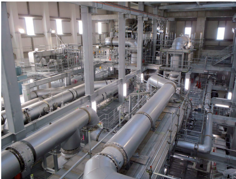
下水汚泥燃料化施設における炭化設備
