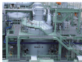
汚泥焼却炉(次世代型汚泥焼却システム)
