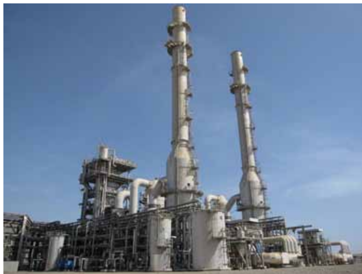
廃液燃焼システム 写真
