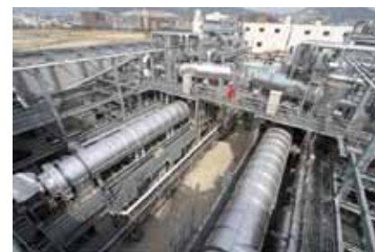
下水汚泥燃料化システム
