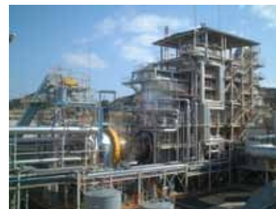
固形廃棄物処理設備
