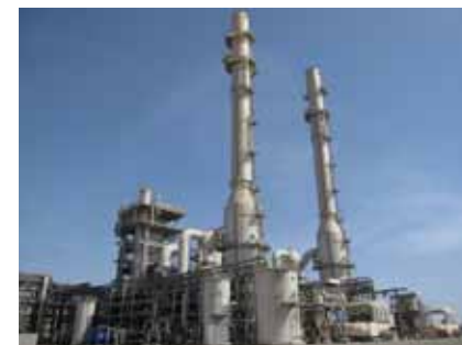
廃液燃焼システム
