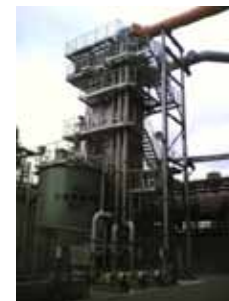
排煙脱硫設備
