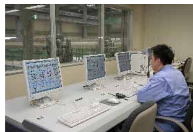
処理場オペレーター室
