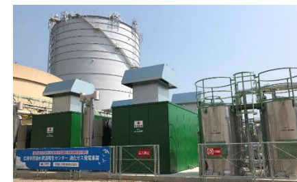
広島西部発電所
