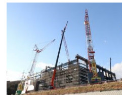
ごみ焼却炉 プラント工事
