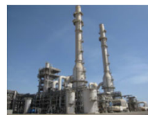
廃液燃焼システム
