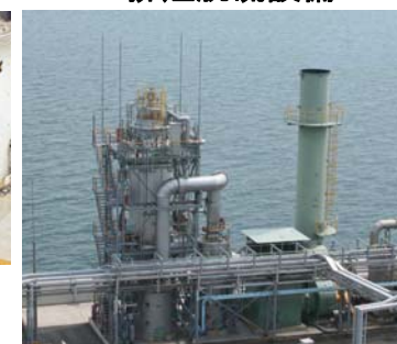
廃液燃焼設備
