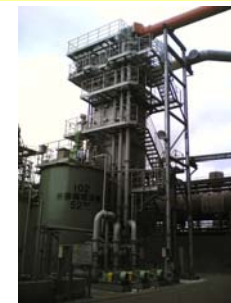
排煙脱硫設備
