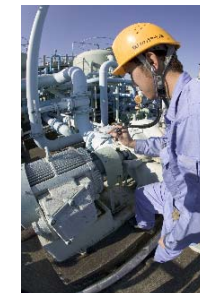
設備メンテナンス
