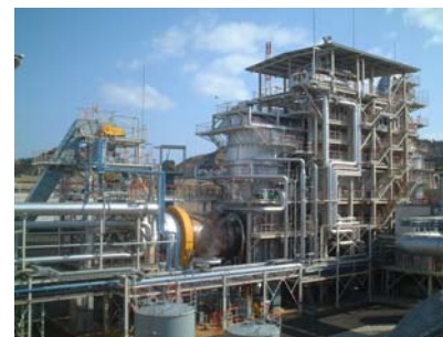
固形廃棄物処理設備
