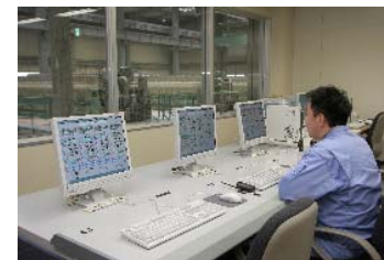
処理場オペレーター室
