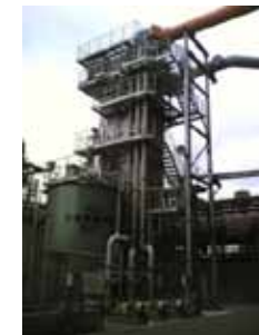
排煙脱硫設備
