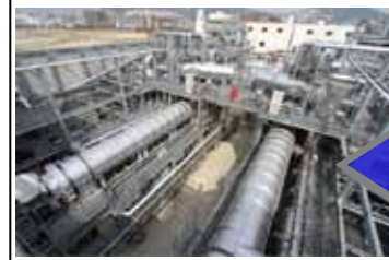
下水汚泥燃料化システム
