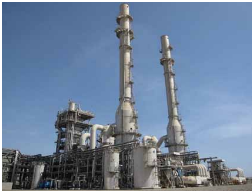
廃液燃焼設備写真
