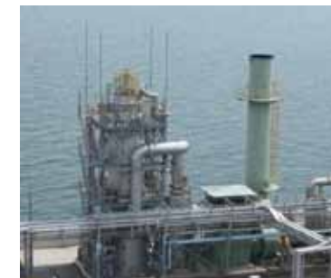
廃液燃焼システム
