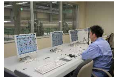
処理場オペレーター室
