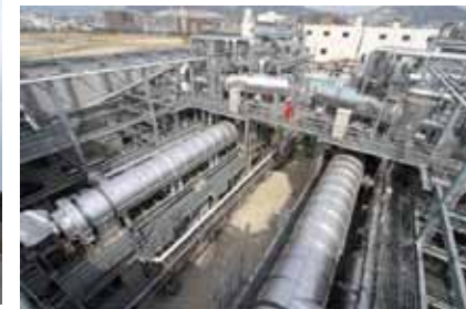
下水汚泥燃料化システム
