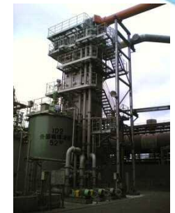
排煙脱硫設備
