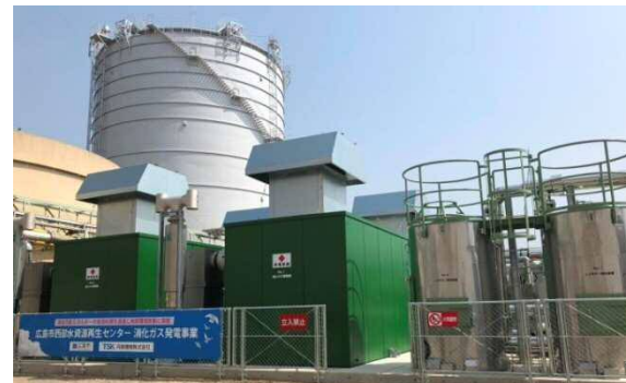
消化ガス発電設備
