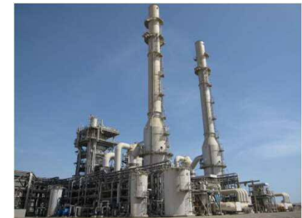
廃液燃焼システム
