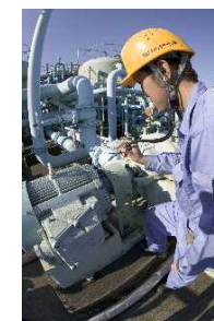
設備メンテナンス
