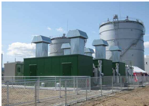
消化ガス発電設備
