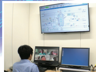
日本の遠隔監視
