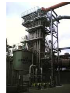
排煙脱硫設備
