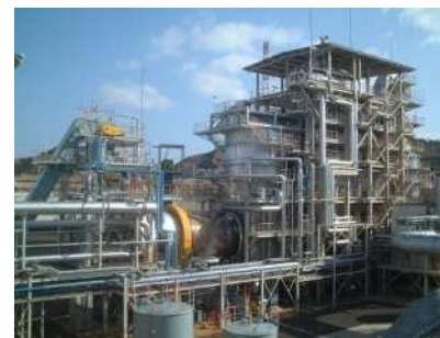
固形廃棄物処理設備
