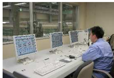
処理場オペレーター室
