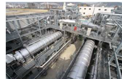
下水汚泥燃料化システム
