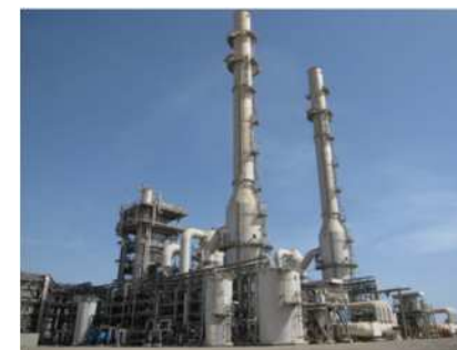
廃液燃焼システム
