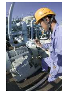
設備メンテナンス
