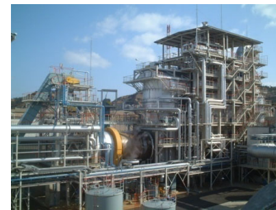
固形廃棄物処理設備
