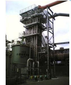
排煙脱硫設備
