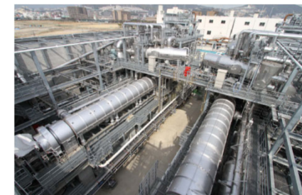
下水汚泥燃料化システム
