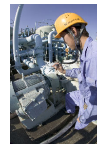
設備メンテナンス
