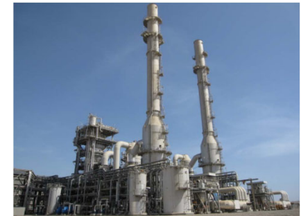
廃液燃焼システム
