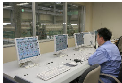
処理場オペレーター室
