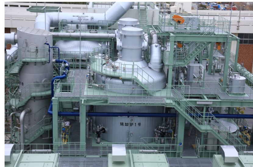
次世代型焼却システム実機写真
