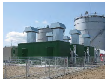
穴道湖東部発電所
