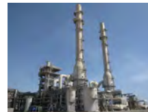
廃液燃焼システム
