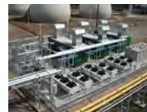
下水消化ガス発電事業
