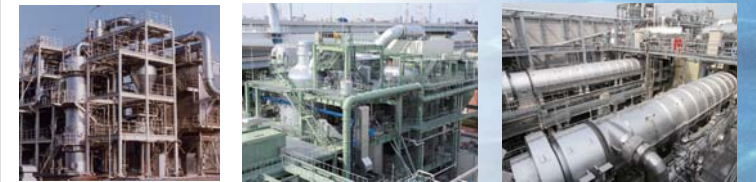
⑨汚泥を無害化する焼却炉・溶融炉
