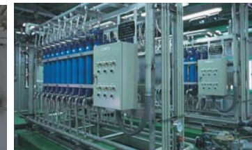
より清澄な水を作る「膜ろ過設備」
