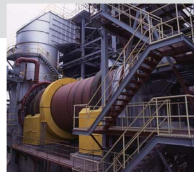
「産業廃棄物焼却設備」
