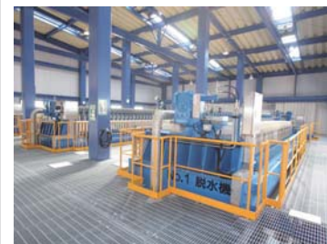
④濃縮排泥を脱水し減容化する「加圧脱水機」
