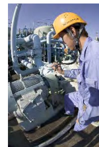
設備メンテナンス
