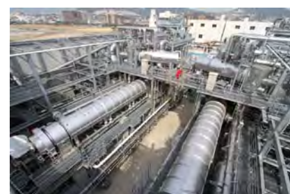
下水汚泥燃料化システム
