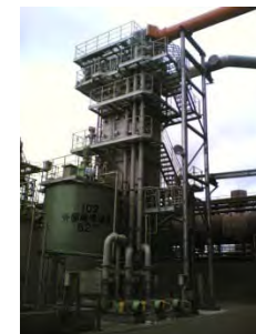
排煙脱硫設備
