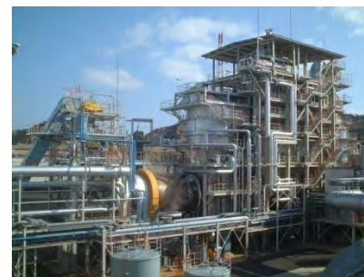
固形廃棄物処理設備
