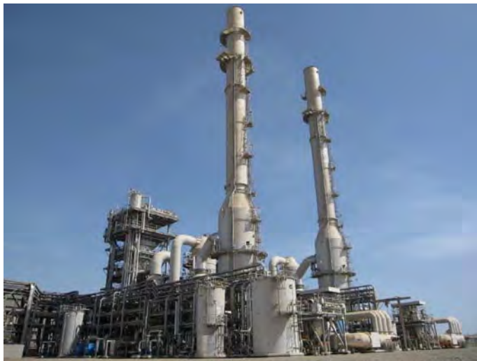
廃液・廃ガス処理設備
