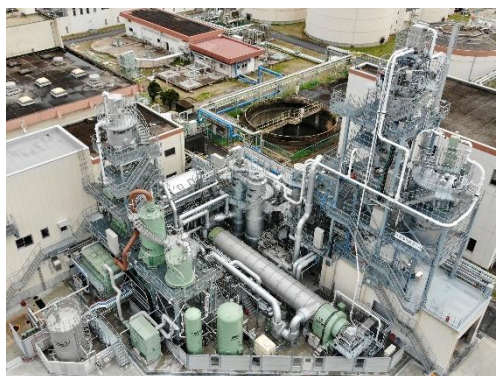
設備全景写真
