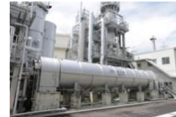
下水汚泥燃料化設備 (熱技術)
