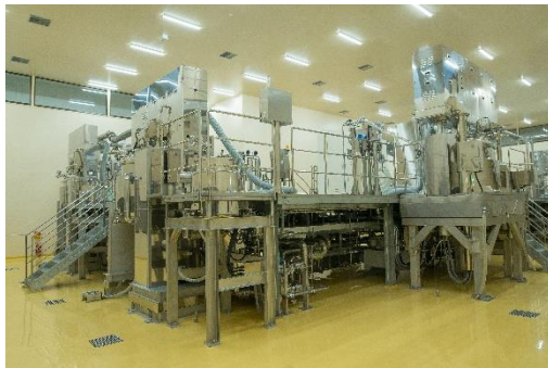
真空乳化機設備(全体)
