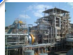
固形物焼却設備
