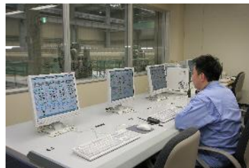
浄水場オペレーター室
