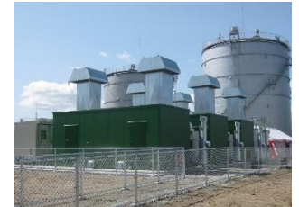
消化ガス発電設備 (消化関連)
