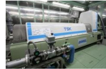
下水汚泥用遠心脱水機
