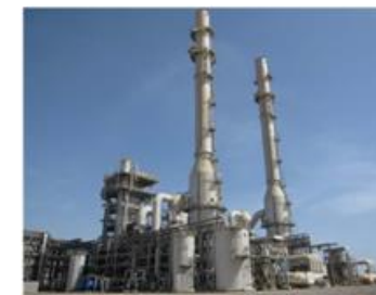
廃液燃焼システム
