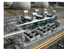
下水消化ガス発電事業
