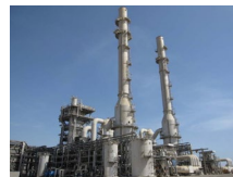
廃液燃焼システム
