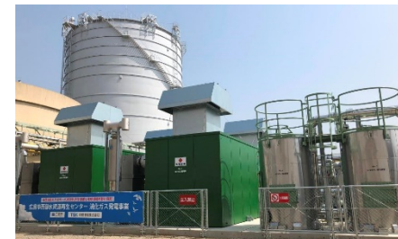
広島西部発電所
