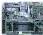
次世代型 汚泥焼却
