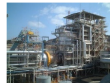
固形廃棄物処理設備
