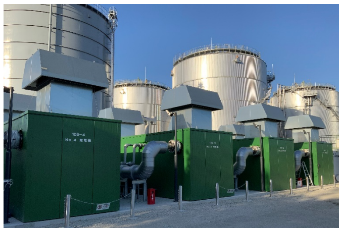
中川消化ガス発電所
