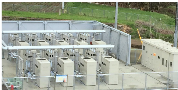
消化ガス発電設備
