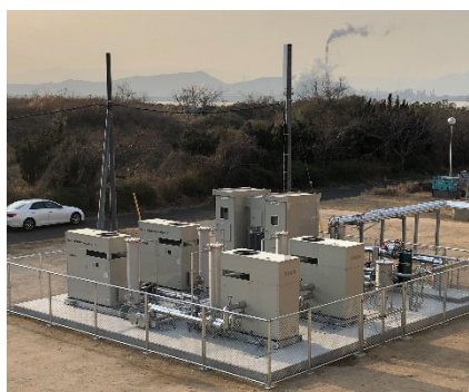
徳山東部浄化センター消化ガス発電設備
