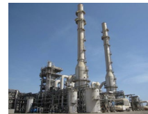
廃液燃焼システム
