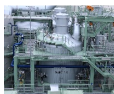
次世代型 汚泥焼却
