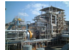
固形廃棄物処理設備
