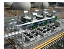
下水消化ガス発電事業
