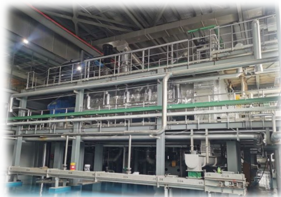
下水汚泥乾燥焼却設備
