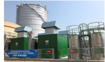
広島西部発電所
