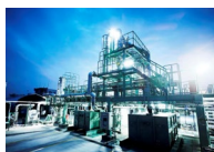
下水汚泥 脱水乾燥
