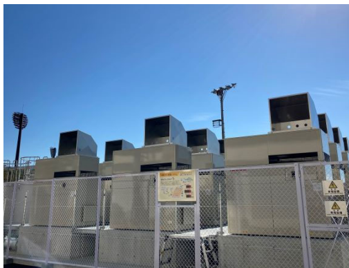
消化ガス発電設備
