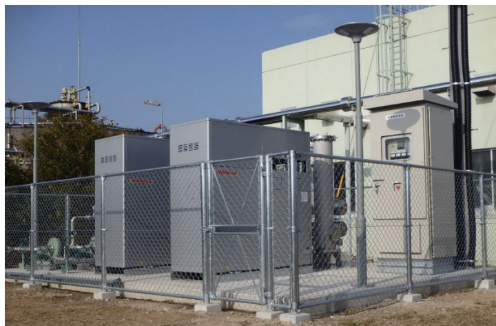
消化ガス発電設備
