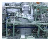
次世代型 汚泥焼却
