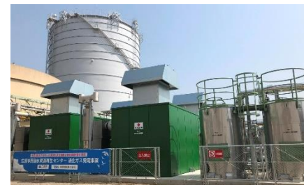
広島西部発電所
