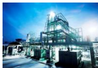
下水汚泥 脱水乾燥
