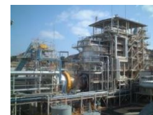
固形廃棄物処理設備
