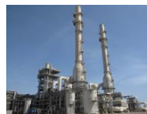
廃液燃焼システム
