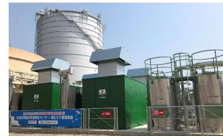
広島西部発電所
