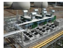
下水消化ガス発電事業
