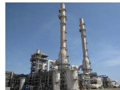
廃液焼却システム
