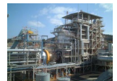
キルンシステム (固形廃棄物処理設備)
