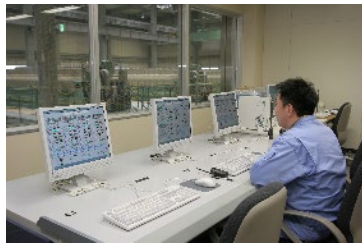
浄水場オペレーター室
