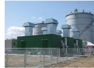
消化ガス発電設備 (消化関連)
