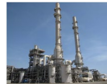
廃液燃焼システム
