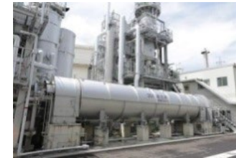
下水汚泥燃料化設備 (熱技術)
