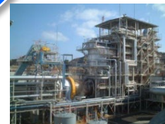
固形物焼却設備
