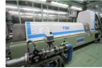
下水汚泥用遠心脱水機
