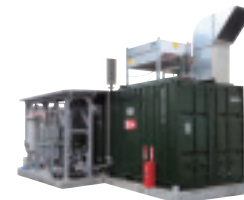
⑥消化ガスを燃料として発電する「ガスエンジン」
