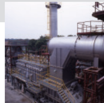
「一般廃棄物焼却設備」
