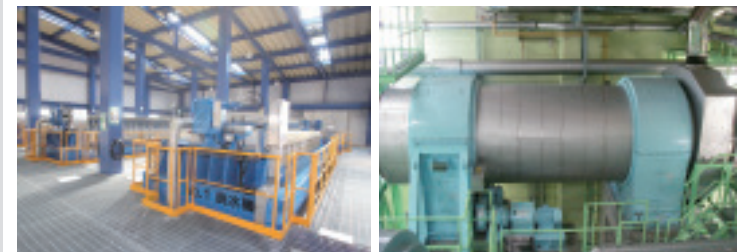
③濃縮した浄水汚泥を脱水し減容化する「加圧脱水機」
