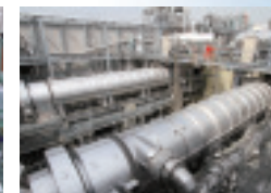
⑩汚泥を燃料化して石炭代替燃料とする「下水汚泥燃料化システム」
