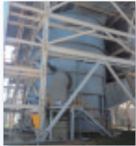
海水法排煙脱硫設備 (モロッコ)
