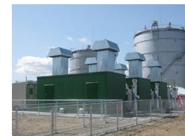
消化ガス発電設備
