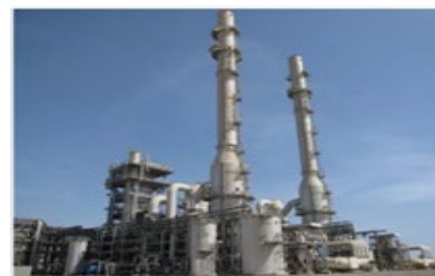
廃液燃焼システム
