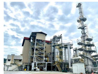
産業廃棄物焼却プラント(マレーシア)
