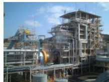
固形廃棄物処理設備
