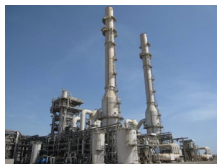
廃液燃焼システム
