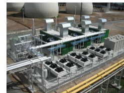
消化ガス発電事業
