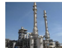
廃液燃焼 システム
