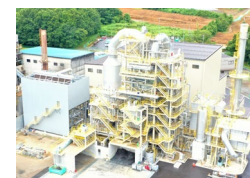
廃棄物処理設備
