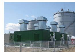
消化ガス発電設備
