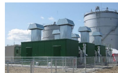
穴道湖東部発電所
