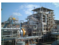
固形廃棄物処理設備
