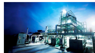
脱水乾燥システム
