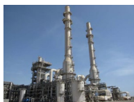
廃液燃焼システム
