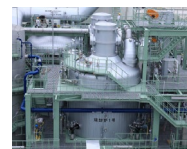
次世代型下水污泥 焼却システム
