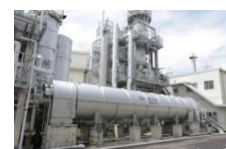
下水污泥燃料化設備
