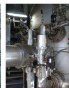
発電型汚泥焼却技術 OdySSEA（オデッセア）
