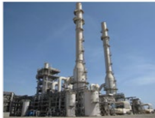
廃液燃焼システム
