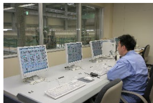
下水処理場オペレーター室
