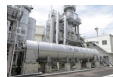
下水污泥燃料化設備
