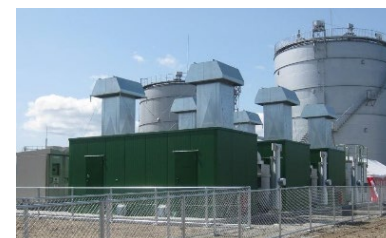
穴道湖東部発電所
