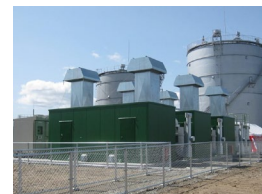
消化ガス発電設備
