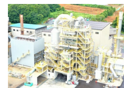
廃棄物処理設備
