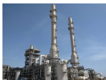
廃液燃焼システム
