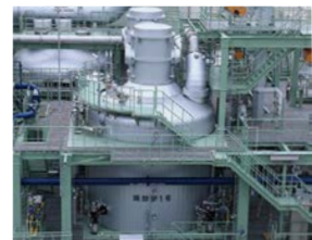
下水汚泥焼却炉
