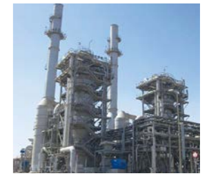
廃液燃焼システム
