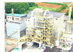
廃棄物処理設備
