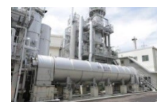
下水汚泥燃料化設備
