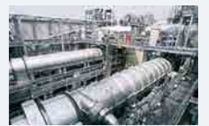
汚泥燃料化設備
