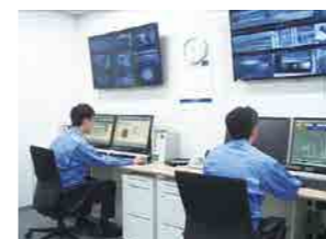
集中監視センター
