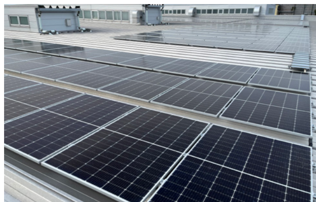
埼玉工場のソーラーパネル
