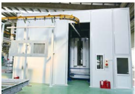
2022年3月稼働の粉体塗装設備
