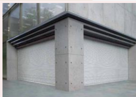
防火シャッター
