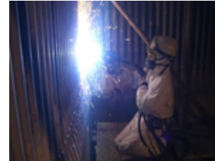
ボイラー （エネルギー、石油化学）
